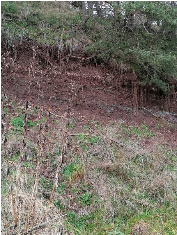
Starke Erosionen an der Westgrenze
